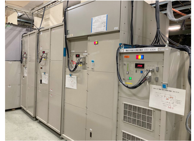
入射器に6台残っている20年以上使用された電磁石電源
