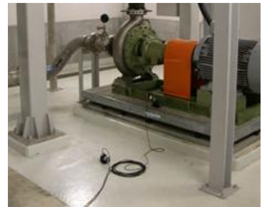
L1冷却水ポンプ
