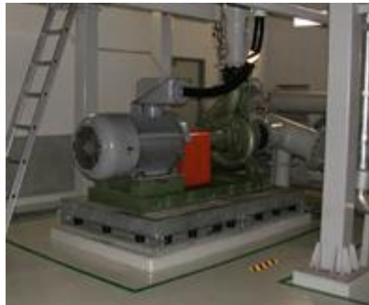
2次冷却水ポンプ
