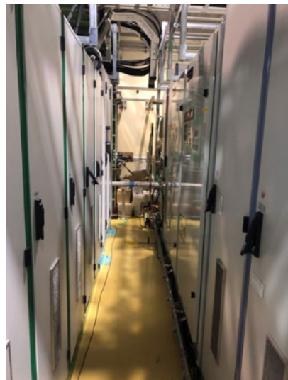
制御盤エリア
