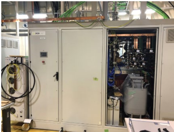
高圧電源装置
