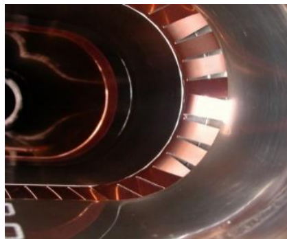
損傷ベローズの内部
