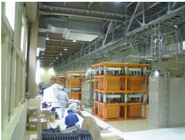
図2：クライストロン高压電源室1設置状況
