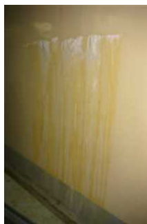
図1 ひび割れ漏水[1]
