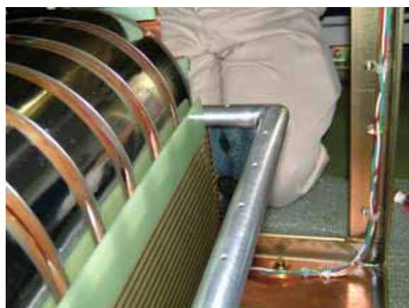
図3:パルストランスの損傷状況。2次巻き線をサポートするFRP板の複数の箇所に放電痕が認められ、該当部の2次巻き線にも外側への膨らみ、カーボンの付着が見られた。
