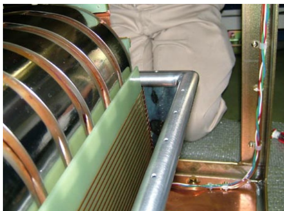
図2 パルストランスの損傷状況。2次巻線用FRP基板上に複数の放電痕が認められ、2次巻き線も外側へ膨らみ、カーボンも付着した。
