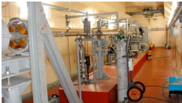
図1：45MeV電子線形加速器本体。一番奥に電子源、その手前に3本の加速管、左側の壁から来る導波管が見えている。
