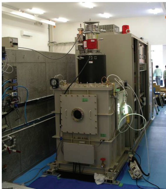
図4：光源加速器棟に設置作業中の高周波源。 (手前側：パルストランスのタンクに装着されたクライストロン、奥：モジュレータ)。
