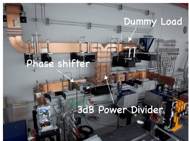
図 2 加速器収納部内に設置された 1428MHz APS 加速システム用立体回路。E ベンド（左上）を介して 30MW の RF 電力が、3dB 電力分配器で各 APS 加速管に供給される。加速管からの反射 RF 電力は 3dB 電力分配器で合成され、終端負荷で消費される。
