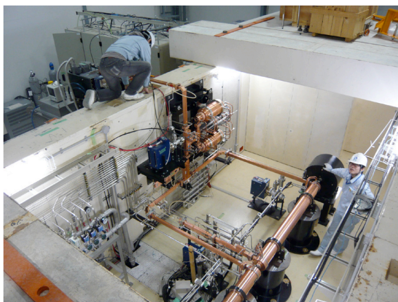
図3 XFELテストスタンドの機器配置写真
