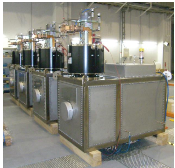
図 2 : XFEL/SPring-8 クライストロンモジュレータの外観。
