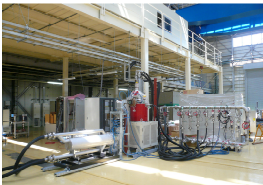
図 5: 東カウンターホールの高周波源の整備状況
