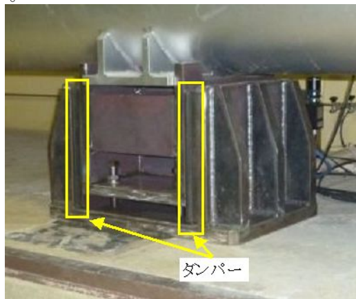
図 16：加速管架台の下に設置された制振器
