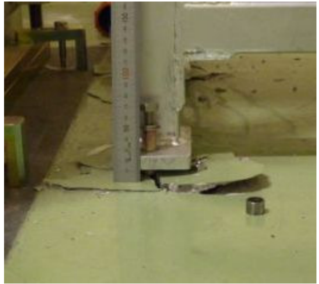
図5：飛び出した QM 架台のアンカーボルト
