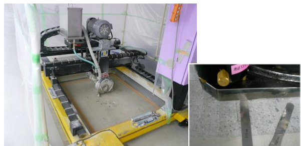
図 8. 研削機 (左) と研削面と架台底面の隙間。
