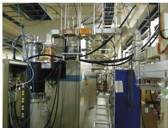
図 2: 1-4 ユニットに設置された L バンドクライストロン（画面左）とその直下流の立体回路（画面右方向へ一旦走り、その後画面手前方向に向かって走っている）の構成。方向性結合器や真空引き導波管は銅製。それ以外のベンドや直管はアルミ合金製。
